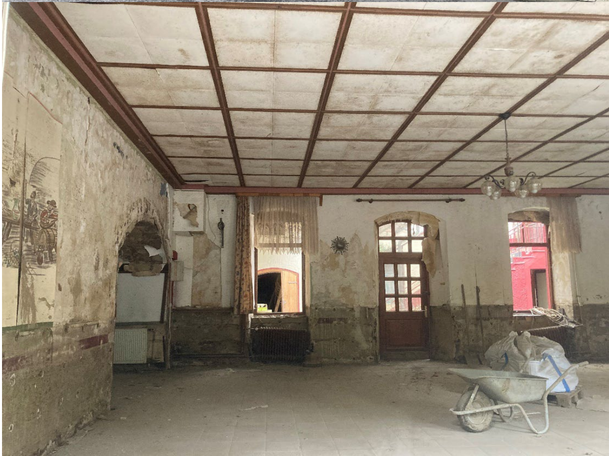
Überschwemmungsschäden in Altenahr nach dem Sturmtief Bernd Mitte Juli 2021
