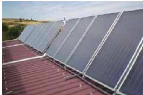
Abb 3-1 Aufgeständerte Flachkollektoren liefern Energie für industrielle Prozesswärme
