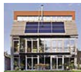
Abb. 2.1: Photovoltaikanlage der Fa. Schüco im Bereich privater Wohnnutzung
