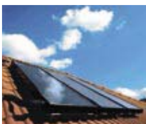
Abb. 2.3: Flachkollektorsystem „Vitosol“ der Fa. Viessman. Es findet eine Heizungsunterstützung durch solare Warmwassererzeugung statt
