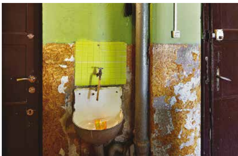
Waschbecken im Flur zwischen zwei Wohnungstüren
